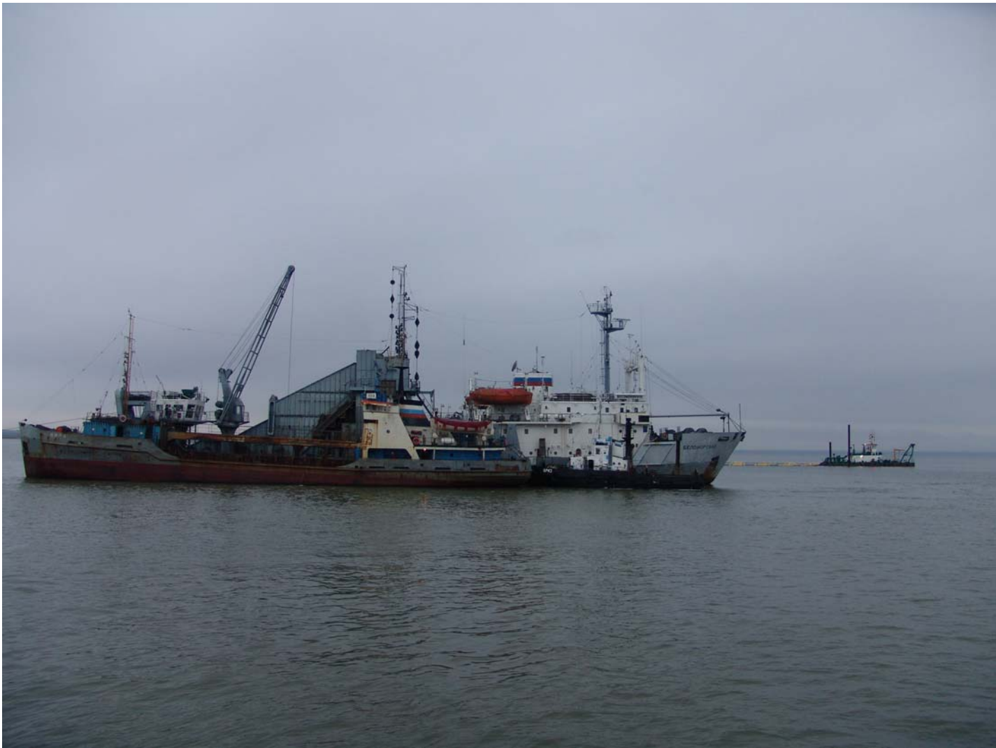
Южная часть Лужской губы в период строительства Паромного комплекса в МТП Усть-Луга (дноуглубление)
